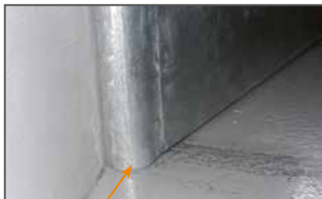
seitliche Räumklappe Achtung: scharfe Kanten! (-> abrunden!)
