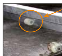
Steuerkufe an Haupträumklappe mit Rolle
